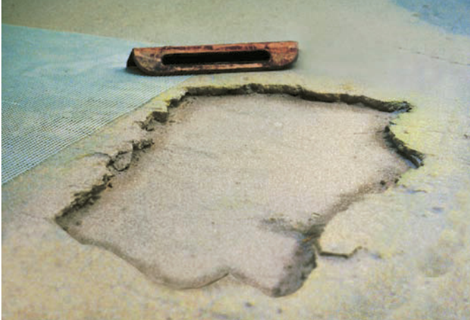
Löcher, Schadstellen, Risse sind Unfallgefahren jedoch kein Problem für Bachmann's Kunstharzböden.
